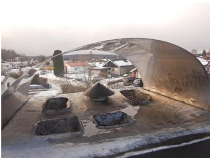
Vattenansamling på topp av skorsten.
