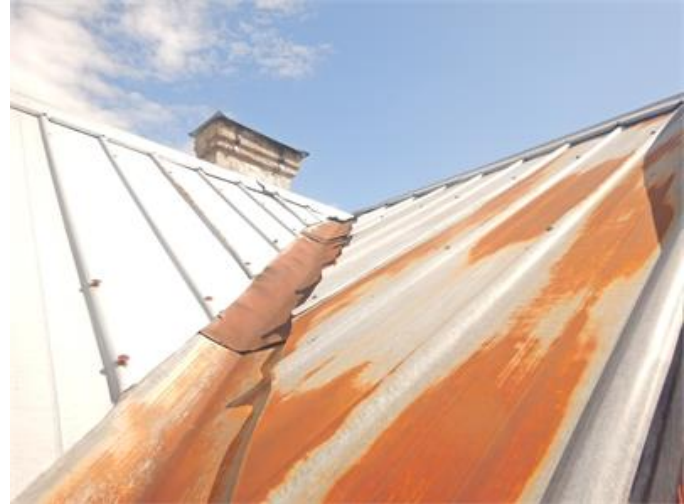
Lösa spikar och rostig plåt i rännedal
