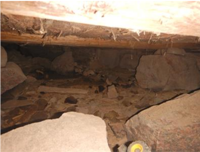
Byggspill på marken i krypgrunden
