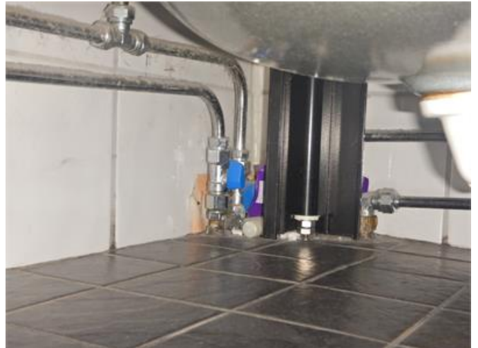
Rör genomföringar i golv bakom badkar.
