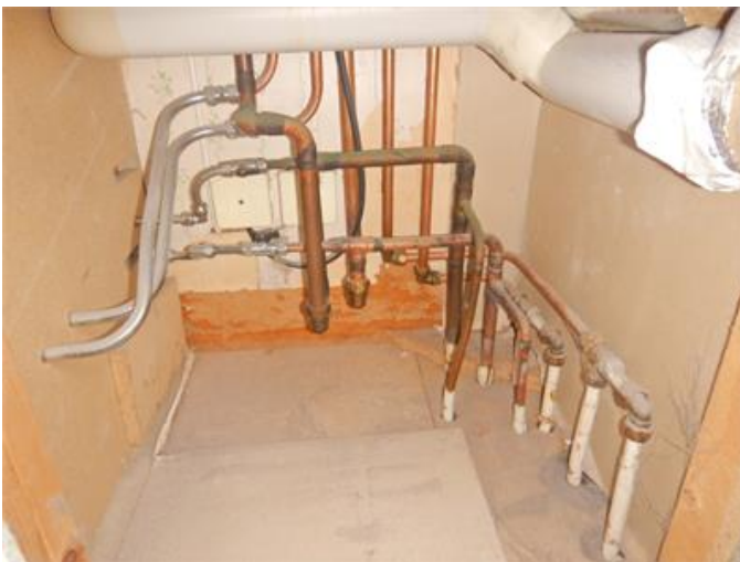
Rörschakt bör tätas och kompletteras med fuktlarm.
