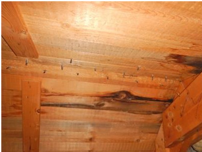
Missfärgning med förhöjd fuktindikation bredvid skorsten.
