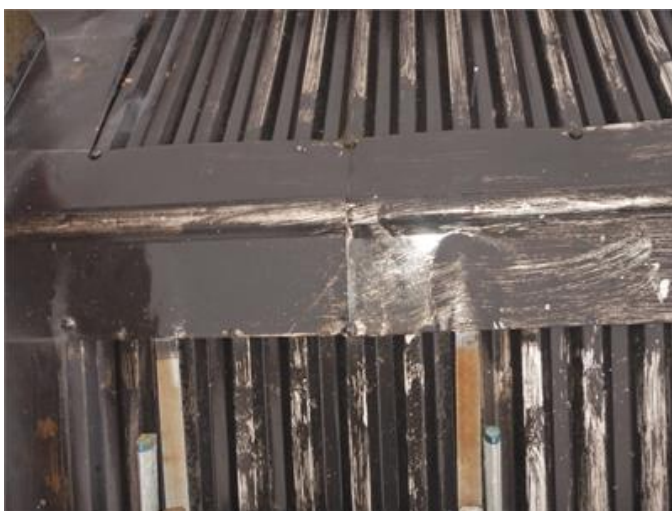
Otätheter ovanför läckage som noterats på vinden.
