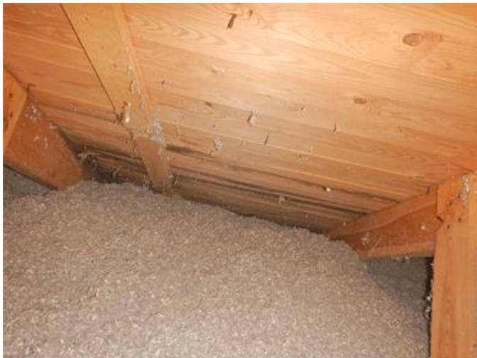
Missfärgning på yttertaketets insida på vinden
