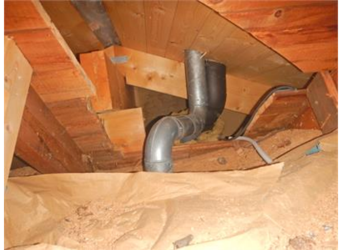
Ventilationskanaler på vind bör isoleras
