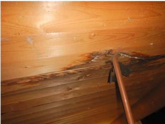
Missfärgning omkring rörgenomföring i talk på vinden
