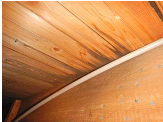
Missfärgning vid takkupa efter tidigare fuktpåverkan.
