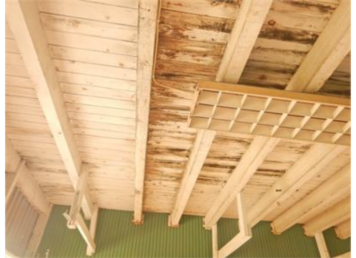
Läckage tak carport
