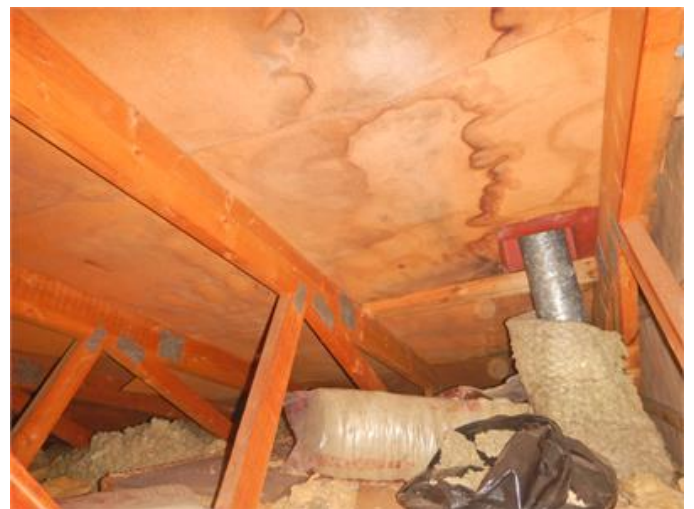
Missfärgning på takskivor efter fuktpåverkan noteras på vinden
