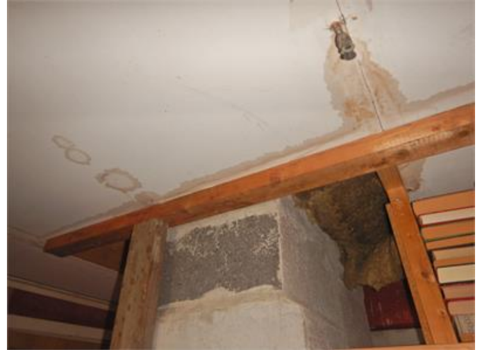
Missfärgning omkring murstock i källaren
