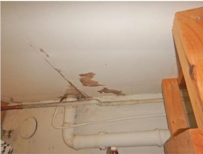
Missfärgning i tak omkring köksavlopp i källaren
