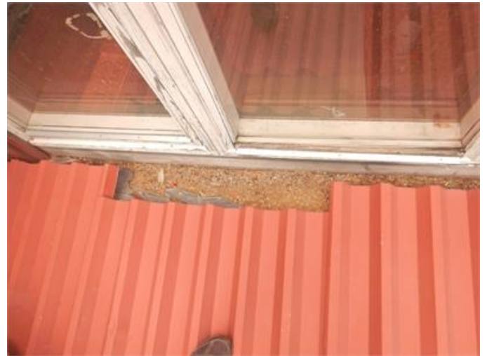
Bristfälligt utförande av takplåt och fönster på garage.
